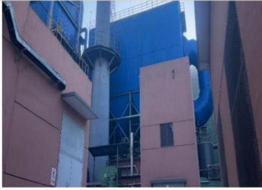
1#、2#石灰窑焙烧烟气脱硫脱硝装置
