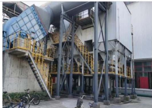
精轧机塑烧板除尘器
