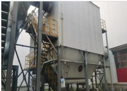
粗轧机塑烧板除尘器
