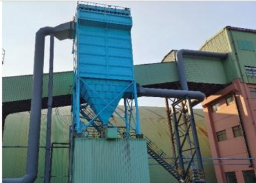
综合料场混匀料仓废气除尘器
