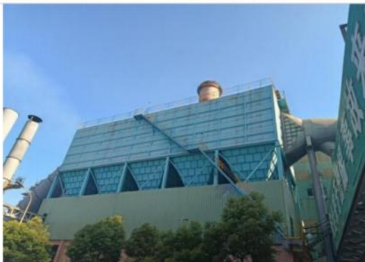
1#、2#烧结机配料废气除尘器
