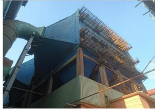
2#烧结机头烟气四电场静电除尘器
