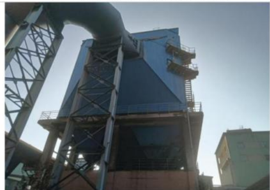
2#烧结机尾废气电袋复合除尘器
