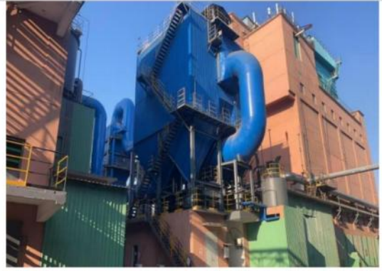
3#石灰窑焙烧烟气脱硫脱硝装置
