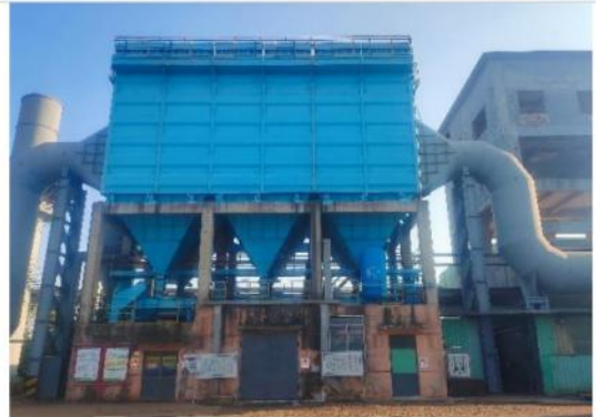
综合料场受料仓废气除尘器
