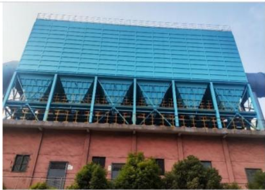
炼钢车间环境除尘器
