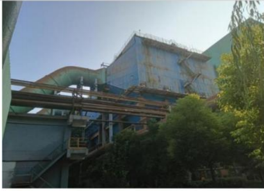
1#烧结机头烟气四电场静电除尘器
