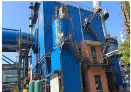
3#高炉热风炉烟气脱硫装置
