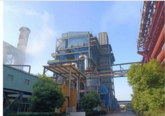
1#、2#烧结机头烟气脱硫脱硝装置
