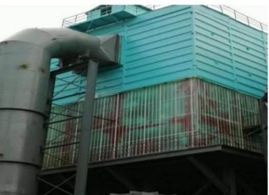
高炉转运站除尘器
