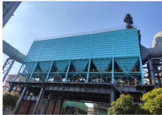
钢包热修除尘器
