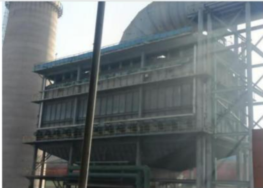
1#、2#烧结机头烟气湿电除尘装置
