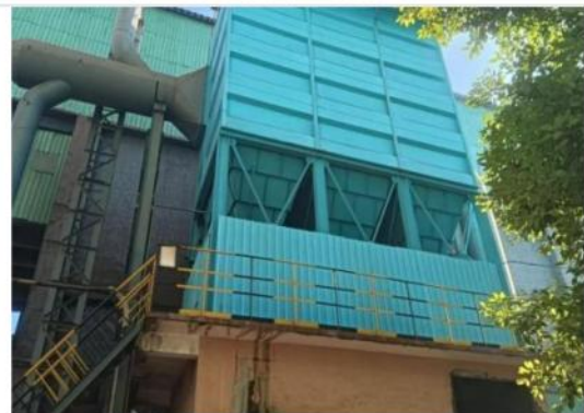
1#、2#烧结机成品料仓废气除尘器
