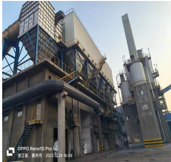
8、二焦干熄焦地面脱硫除尘
