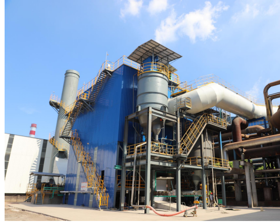
12、高炉热风炉脱硫除尘
