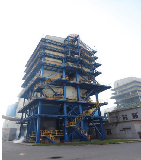
2、450 m 3 烧结机烟气脱硝装置
