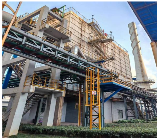
4、450 m 3 烧结整粒筛分除尘
