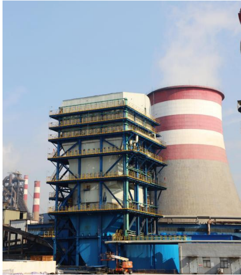
1、300 m 3 烧结机烟气脱硝装置
