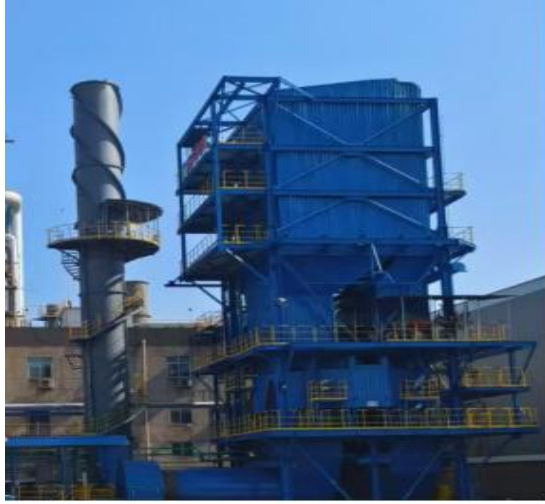
5、石灰窑烟气脱硝装置
