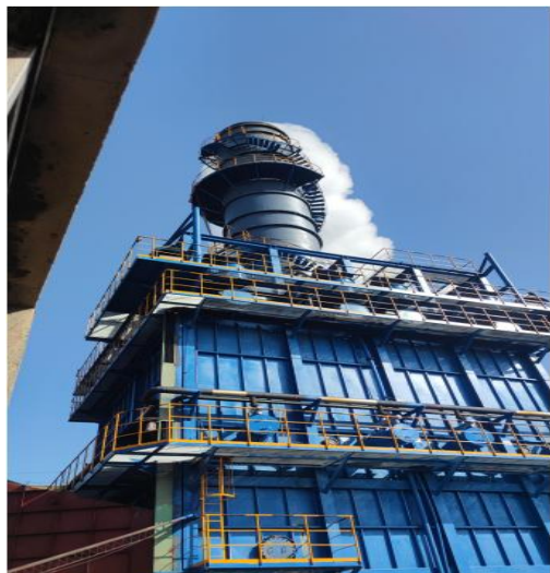
9、一焦焦炉脱硫湿电除尘
