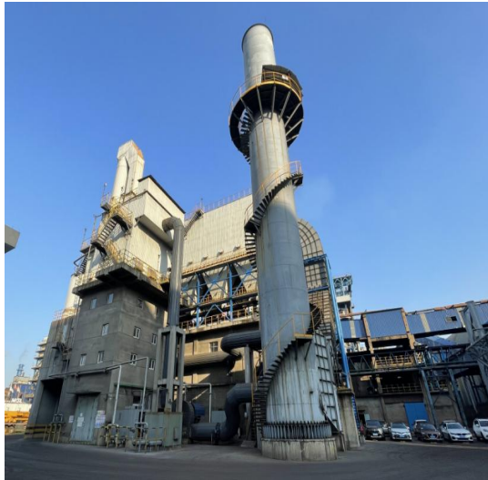
7、一焦干熄焦地面脱硫除尘
