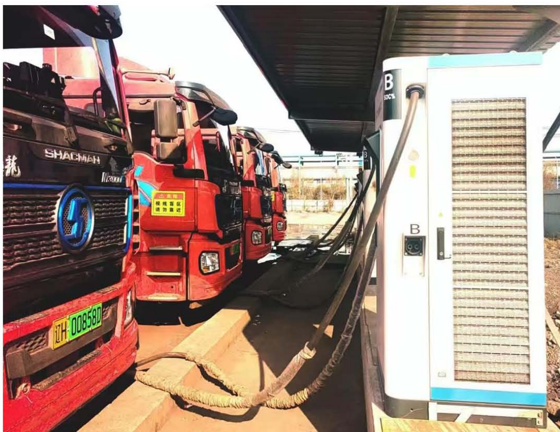
（上图为新能源电动重卡充电桩）
