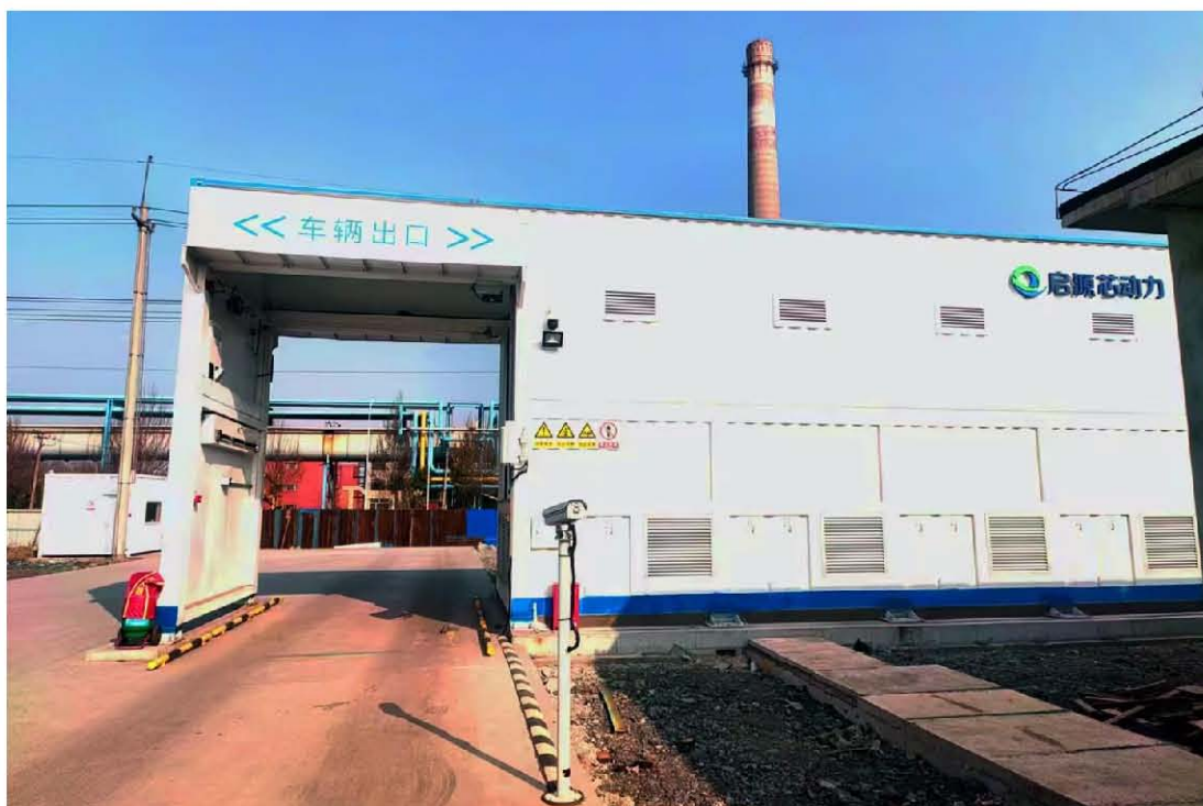
（上图为新能源电动重卡换电站）
